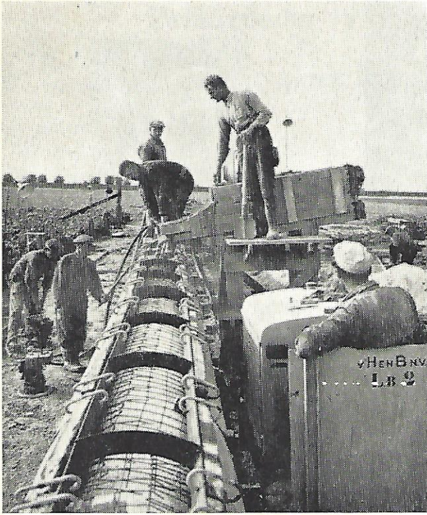
VERZWAREN. Bij het Hollandsch Diep wordt de pijpleiding met gewapend beton verzaard.
